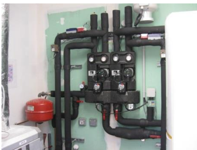
Vue des 2 départs Nord et Sud chauffage
