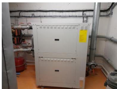
Photo des PAC en local technique
